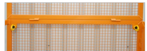
Points d'ancrage pour PSA (EPI)
