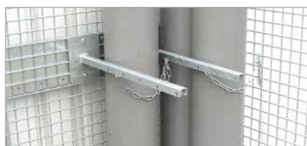
Dispositif de maintien des bouteilles de gaz de, sécurisé par chaîne.
