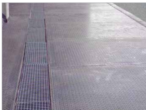
Gouttière avec caillebotis
